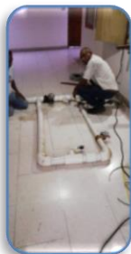
CUARTO DE CÁMARA
